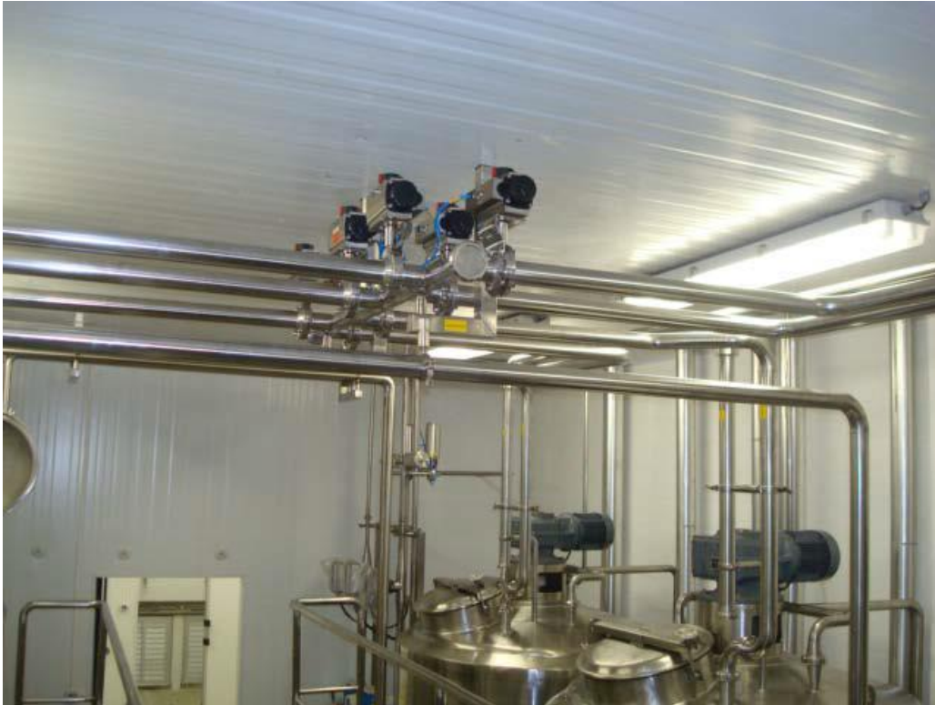
Figura 8 - Conjunto de válvulas dosadoras
