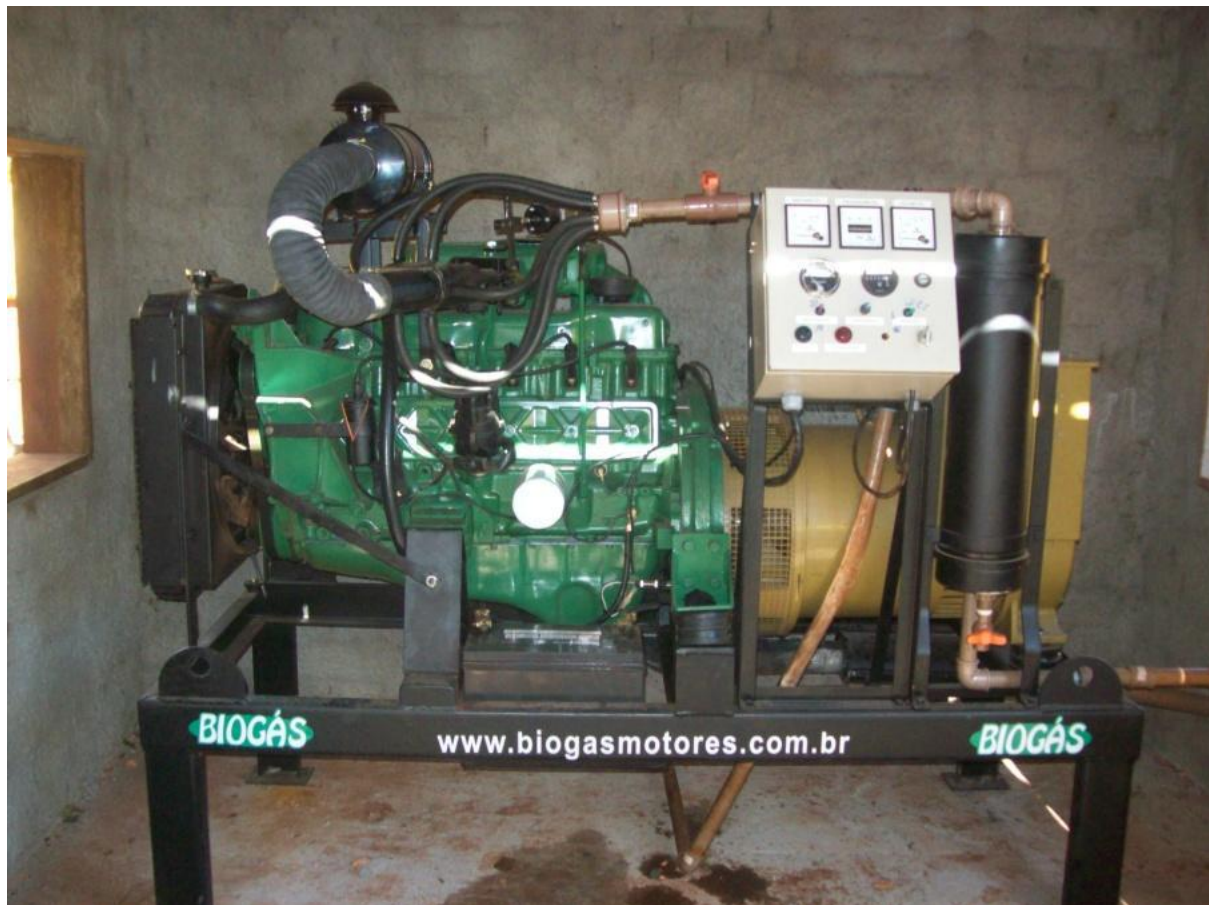
Figura 2: Conjunto motor-gerador Fonte: A BARICHELLO, R. et al. (2012)
